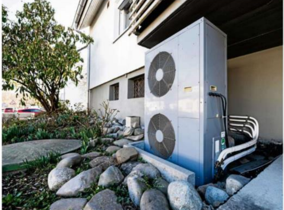
Nicht immer ansehnlich und mitunter laut – aber die Zukunft. Die Lüftungsanlage einer Wärmepumpe steht vor einem Wohnhaus.
